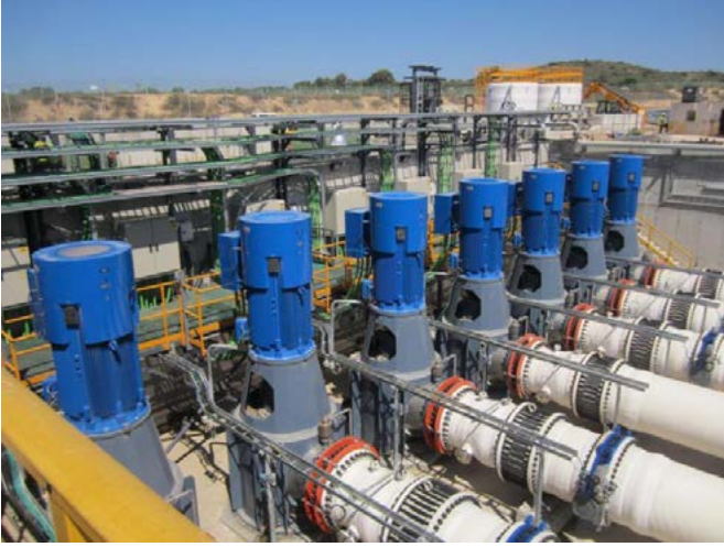
Şekil 11: İsrail'de bir tuzlu su arıtma tesisi.
